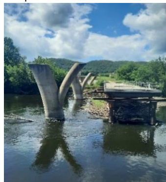
Infrastructure de génie civil du pont de Fayrac (estacade et piles de pont)
